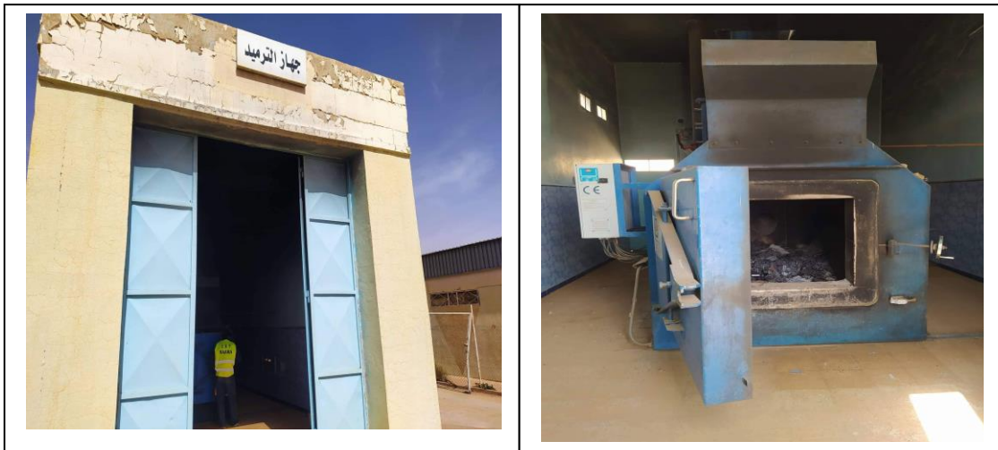
Figure 12 : L'incantateur installé au niveau du CET intercommunale –Mecheria.
