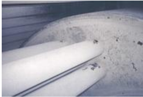
Figure II.2: Entartrage d'une chaudière à tubes de fumée (P= 15 bars)
