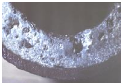
Figure II.3 : Dépôt de forte épaisseur dans un tube de surchauffeur de chaudière MP
