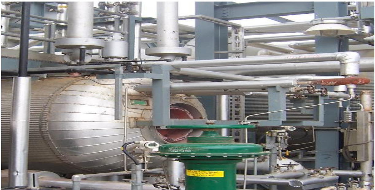
Figure II-13: le ballon chaudière.
