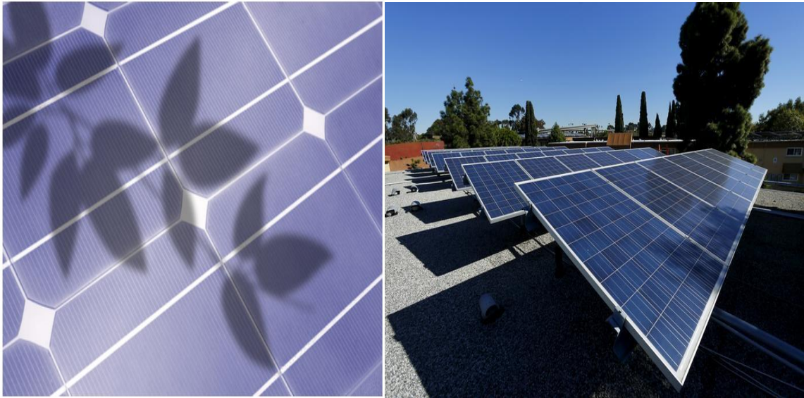
Figure II.4 : Défaut d'ombrage partiel.
