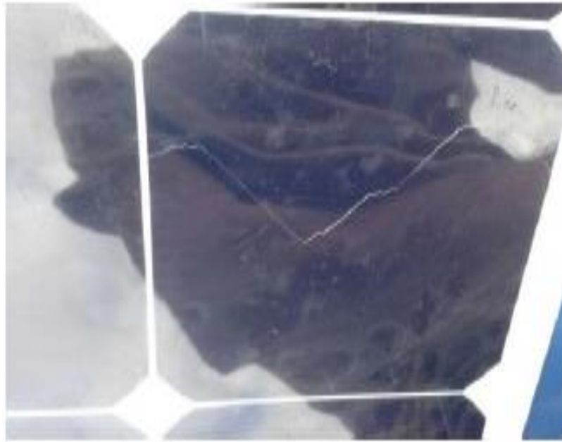
Figure II.3 : fissures dans les cellules photovoltaïque.
