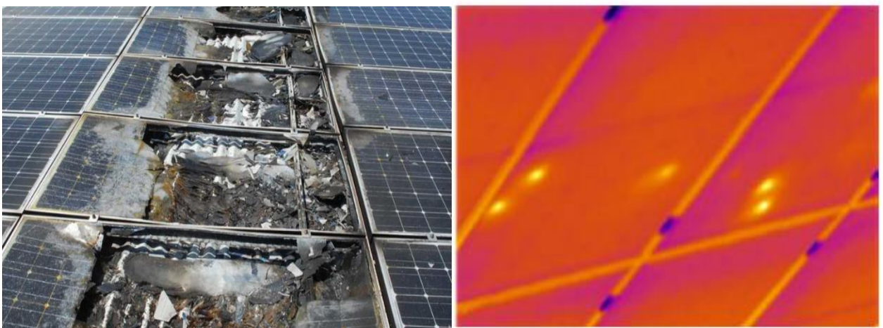
Figure II.6 : défaut de point chaud.
