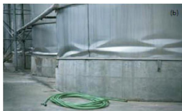
Figure 2. Flambement au sommet des murs (due au ballonnement).
