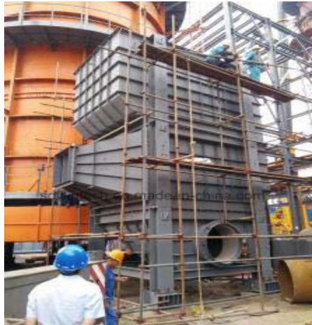
Figure II.27 : Echangeur à Bloc.
