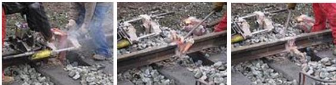
Figure 13. Utilisation d'une thermite pour le soudage de rails. Les températures atteintes lors des réactions chimiques en phase solide de l'aluminium avec des oxydes de fer sont assez élevées pour permettre le soudage.
