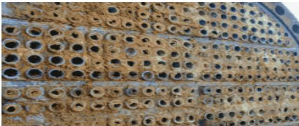
Figure II.9 : L'encrassement dans un échangeur tubulaire
