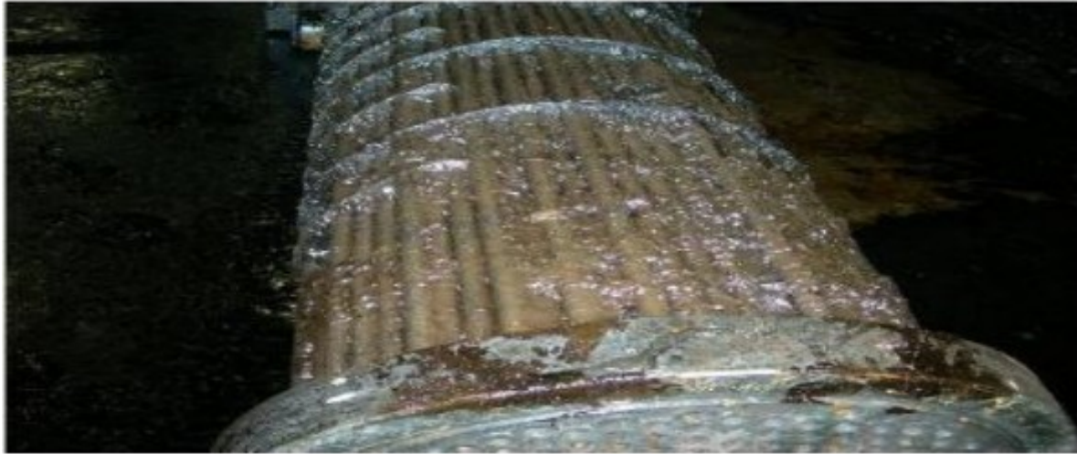
Fig. II.17: Exemple d'un faisceau de tubes d'un échangeur encrassé
