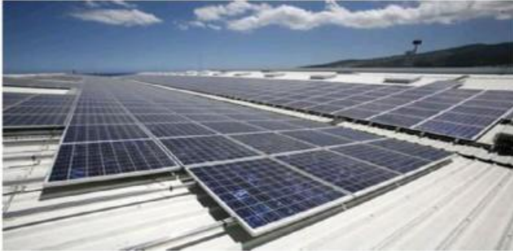
Figure I.5 : Photo d'une centrale solaire [1].
