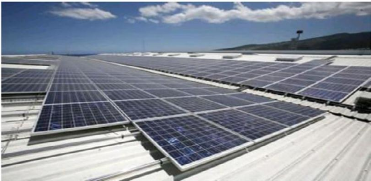
Figure I.2 : Photo d'une centrale solaire
