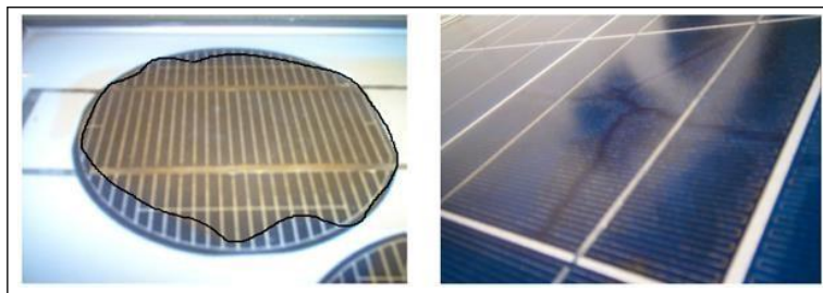
Figure II. 13: Modules photovoltaïques avec des cellules décolorées.
