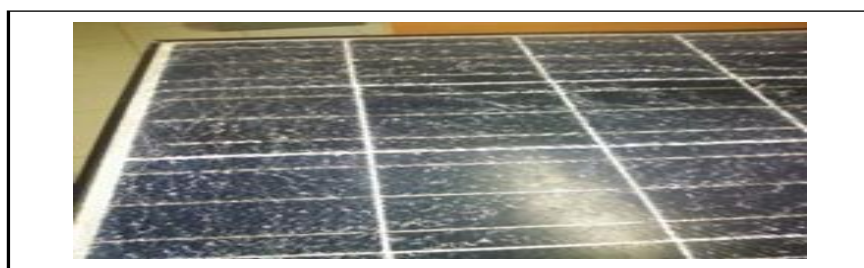
Figure II. 14: Module photovoltaïque présentant des bris de verre.
