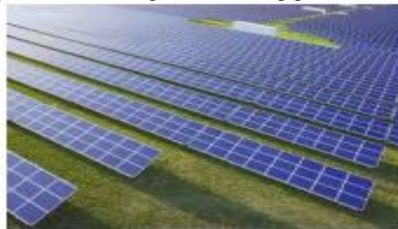
Figure (I.09) : Un champ photovoltaïque.
