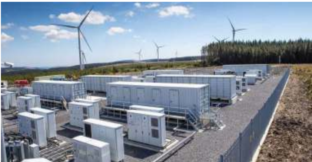
FIGURE I.24 : Stockage d'énergie éolienne par Batterie
