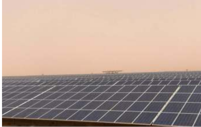
Figure III.12 : Centrales solaire de la wilaya de Naama
