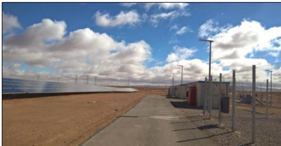
Figure 2.8 : Centrale solaire électrique photovoltaïque de la SKTM
