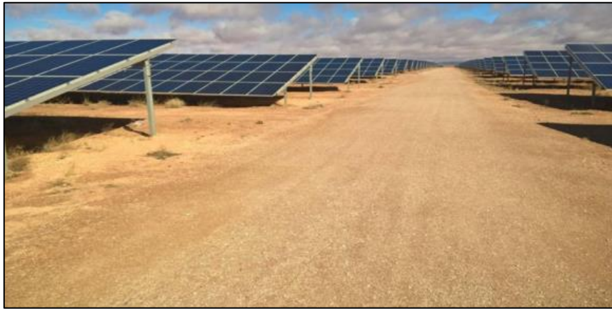
Figure 2.9 : Représentatif des panneaux photovoltaïques dans la centrale SKTM
